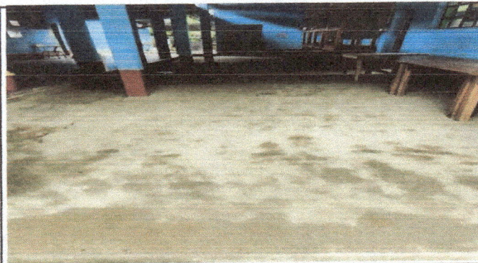
Corredor de las aulas, entortado en mal estado
