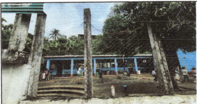
Malla perimetral en mal estado
