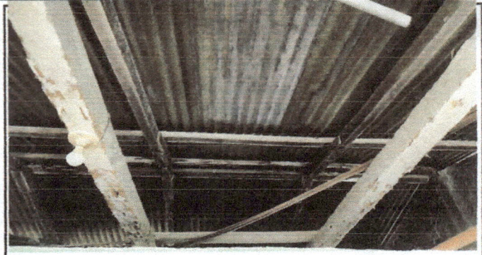
Estructura de madera podrida con peligro a caerse
