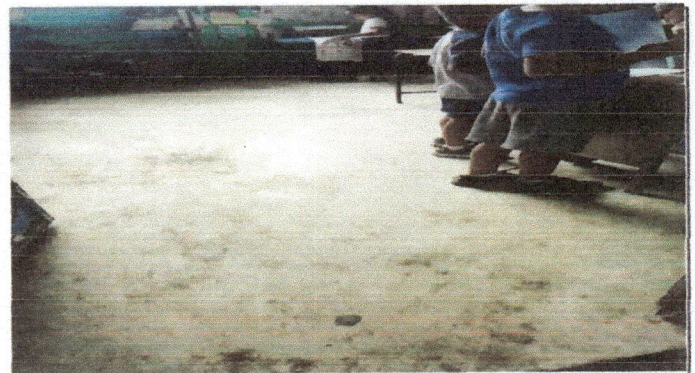
Piso de las aulas, entortado manchado y deteriorado
