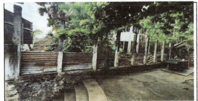
Deterioro y agujereada la malla perimetral
