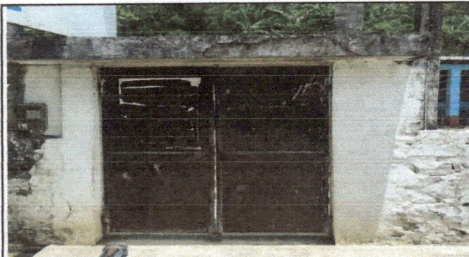
Portón principal averiado, despintado y de mal aspecto
